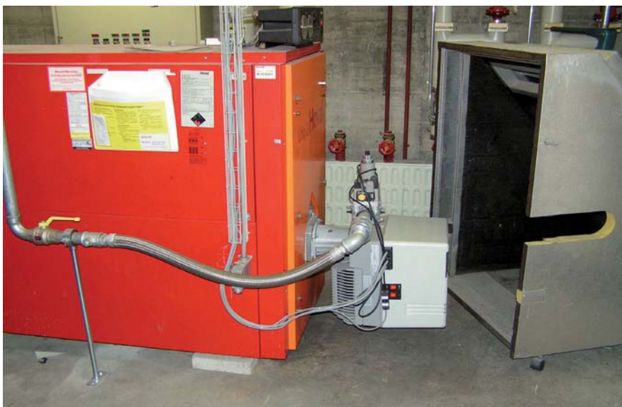
Die mit Erdgas betriebene Heizung der Firma Fontana & Fontana AG in Jona.
