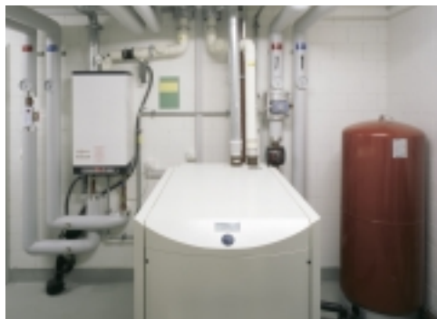
Mini-Blockheizkraftwerk und Gaskondensationskessel in einem Mehrfamilienhaus.
